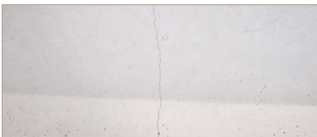
Abb. 73: Beispiel oberflächlicher Riss
