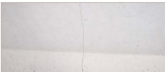
Abb. 66: Beispiel oberflächlicher Riss
