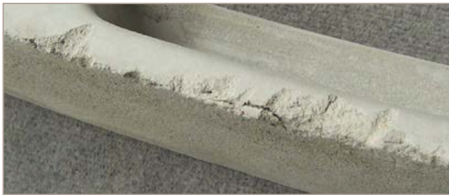
Abb. 65: Beispiel oberflächliche Abplatzungen
