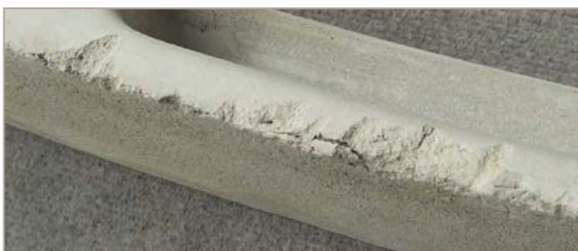
Abb. 60: Beispiel oberflächliche Abplatzungen
