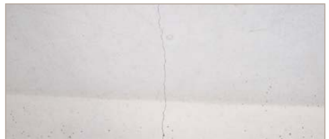
Abb. 61: Beispiel oberflächlicher Riss
