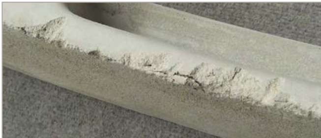
Abb. 22: Beispiel oberflächliche Abplatzungen
