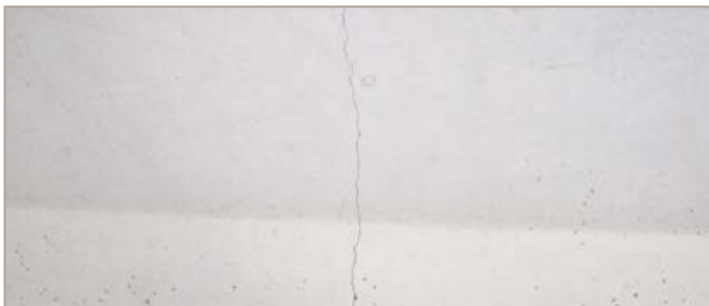
Abb. 23: Beispiel oberflächlicher Riss
