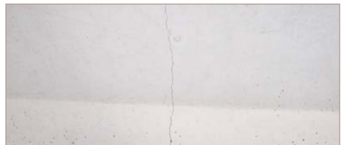
Abb. 70: Beispiel oberflächlicher Riss
